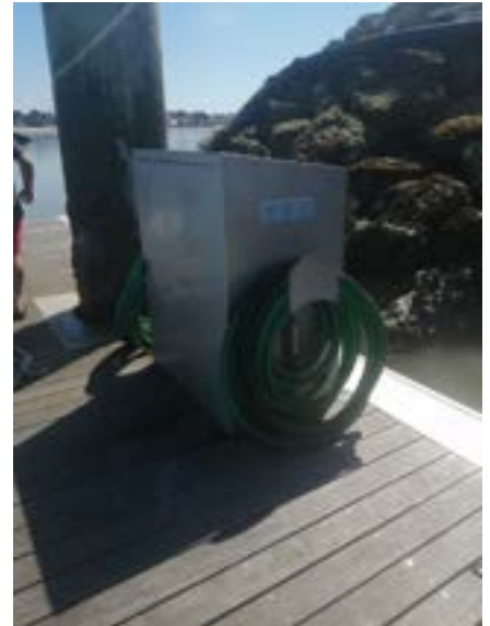
L'installation de pompage des eaux usées par aspiration au port de Royan
